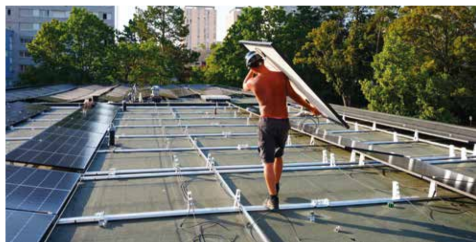
Pour l'école maternelle, les panneaux photovoltaïques sont directement installés sur le toit de l'école.
